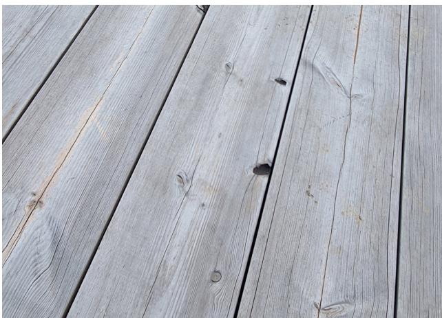
Luonnollisesti harmaantunut Lunawood-terassi 2 vuotta asentamisen jälkeen. Pinnassa on havaittavissa puulle tyypillisiä hiushalkeamia.
